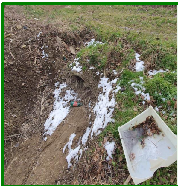
Slika 13. Uljev propusta 2 u potpunosti začepljen nanosom (Izvor: Tau projekt d.o.o.)
