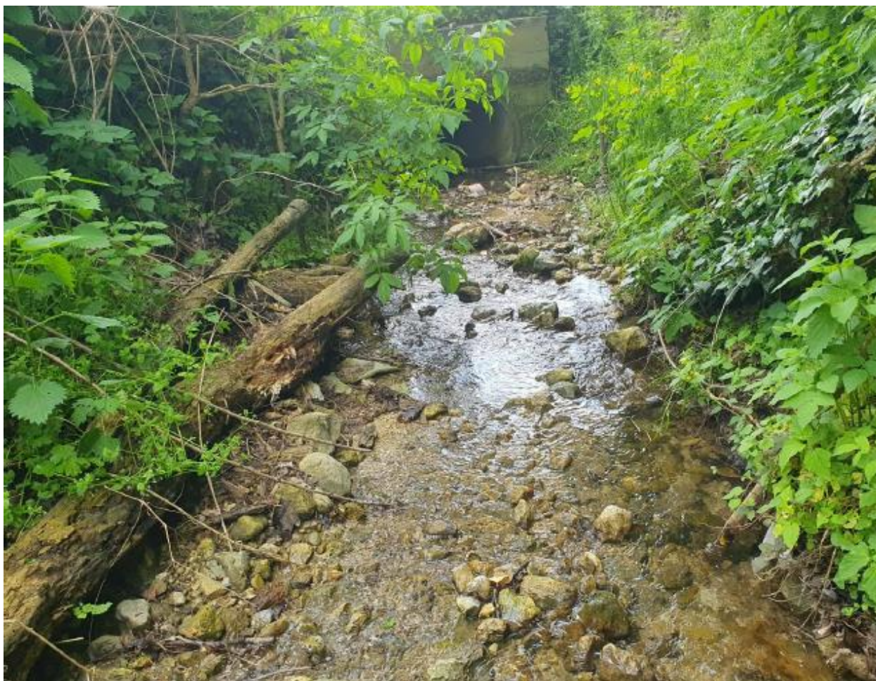
Slika 19. Prikaz erozije uzvodno od propusta 4. (Izvor: Tau projekt d.o.o.)
