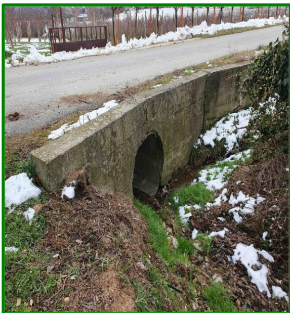
Slika 7. Cijevni propust 5 – uljev propusta (Izvor: Tau projekt d.o.o.)
